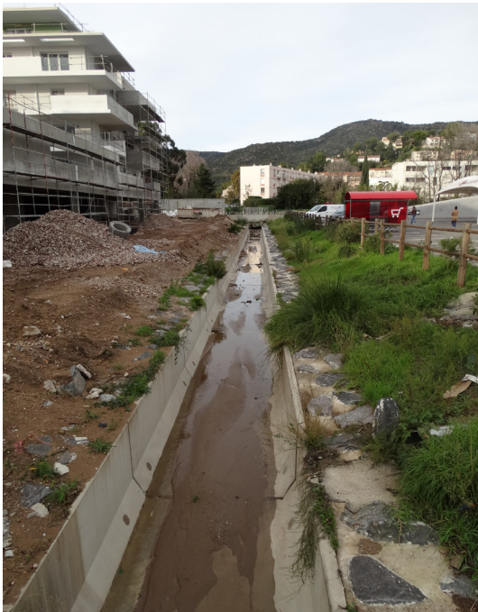
Canal de déviation de la Vieille vers le Batailler, Photographies personnelle, Lavandou, 2020
