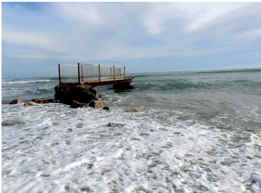
Les dégâts de l'érosion sur littoral Camarguais.
